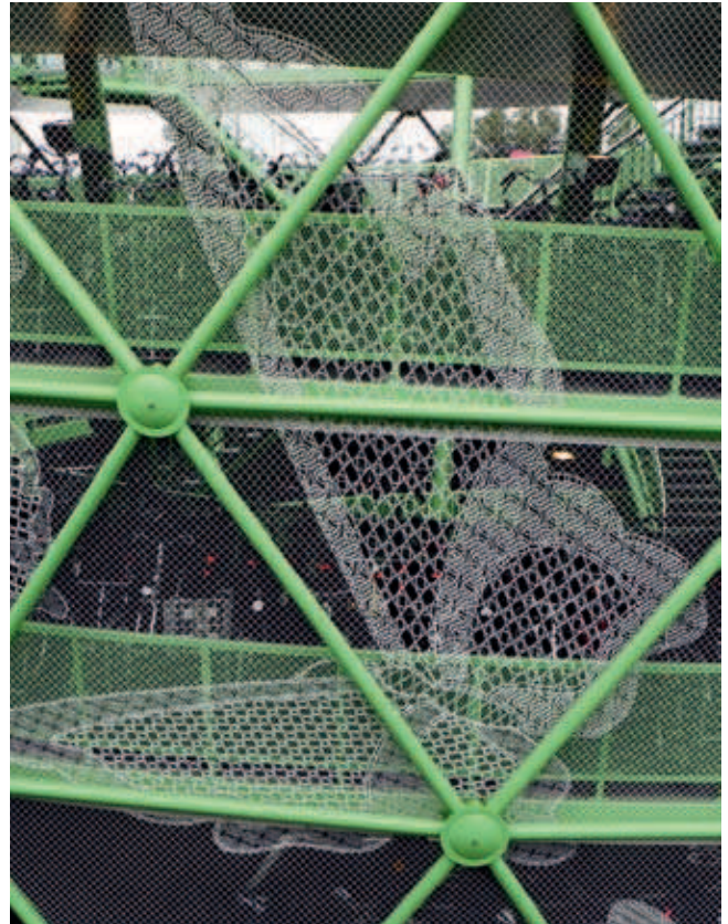
Constructiebuizen met gaasvakkens
